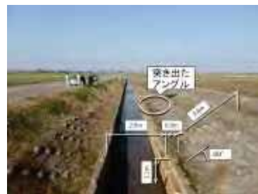
事故現場の状況
