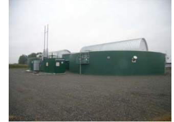
バイオガスプラント
