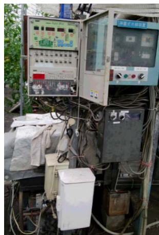
複合環境制御盤
