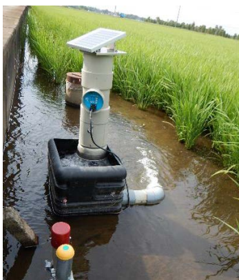
写真1 給水バルブに設置した電動アクチュエータ
