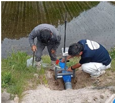
自動給水システム（給水ゲート設置）
