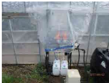
コントローラと液肥混入器
