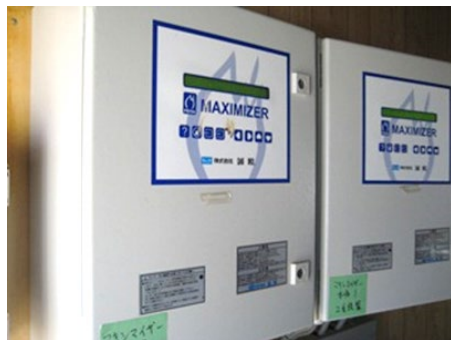
統合環境制御システム基盤
