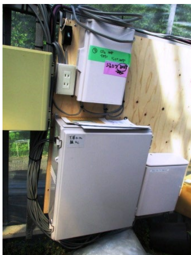
統合環境制御装置
