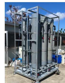
▲ Watasumi（株）の製造した排水処理装置
