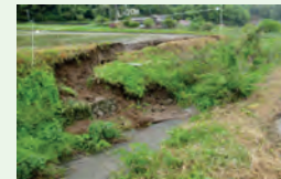
地震による農地法面の崩壊
