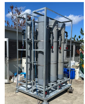
▲ Watasumi（株）の製造した排水処理装置
