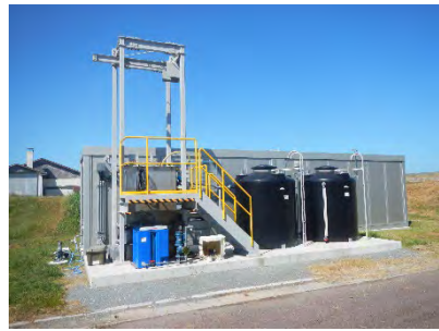
築上町の液肥濃縮施設
