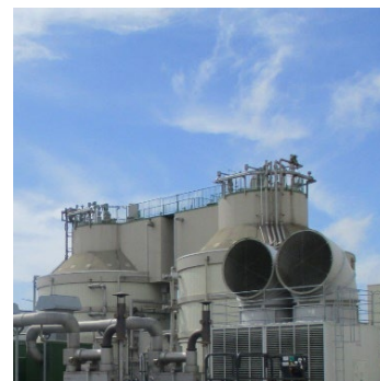
バイオマスガス発電施設（秋田市）
