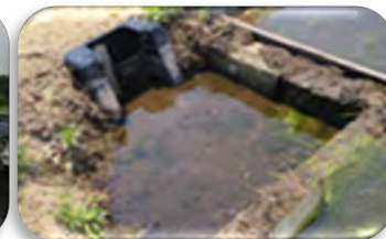
田んぼダムの設置状況
