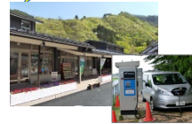
EV車等への給電設備
