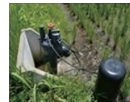
管水路フロート式センサによる止水。手前の黒い筒状のものがフロート。
