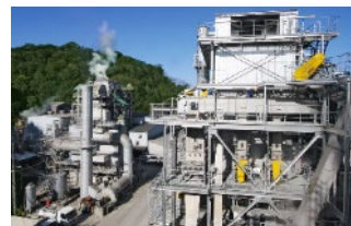
鶏糞燃焼発電ボイラー
