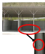
○ブロワーの整備による 堆積+通気
