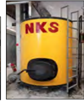
薪ボイラ(CWKH社仕様)
