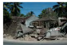
RC柱レンガ組住宅の倒壊状況
