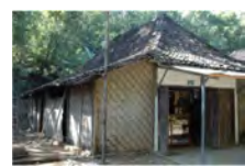
木柱と竹網壁の組み合わせによる住宅(外側のレンガ組壁は倒壊)
