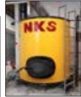
薪ボイラ(CWKH社仕様)
