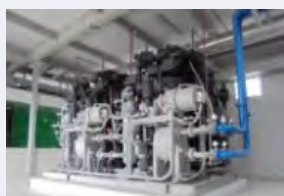
冷蔵倉庫: NewTon R-6000 (写真提供: すべてMAYEKAWA INDONESIA)
