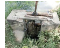
老朽化したゲート
