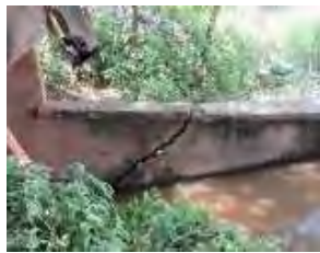
農業水利施設の劣化
