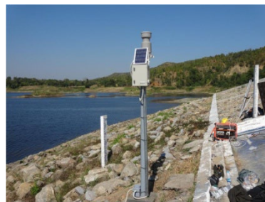
写真一1 遠隔計測通信装置
