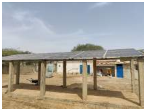
図 40 太陽光パネル
