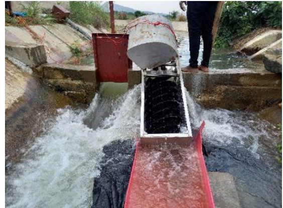
小水力（CY幹線水路発電試験）
