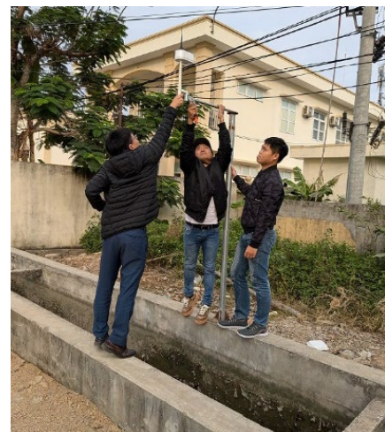
写真 5 ゴズン PS 下流水路へのセンサ設置
