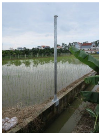
写真 2 カメラ設置用の鋼管支柱
