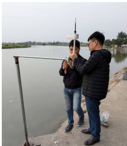
写真 4 ゴズン PS 上流部への水位センサ設置
