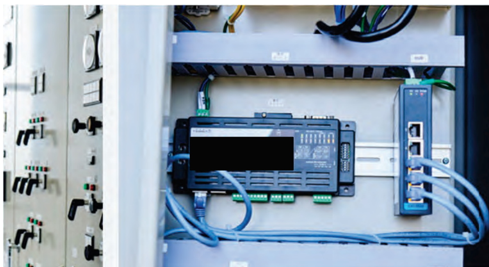
写真-3. 10. 3 揚水ポンプ自動制御システム (既存手動システムに後付けで遠隔操作機能を追加)
