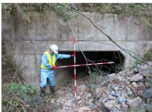
図-10.2.8 土石流入による水路カルバートの通水阻害 23)
