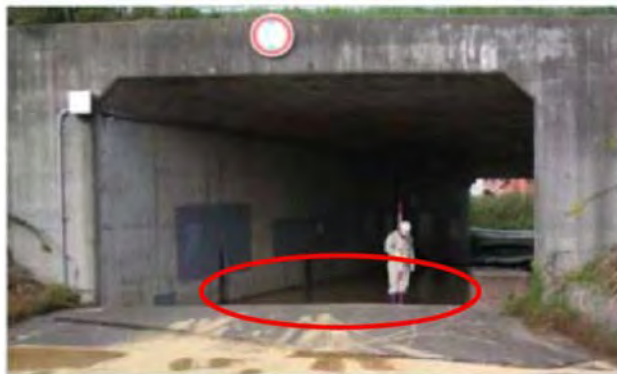
図-10.2.6 カルバートの沈下による帯水 22)
