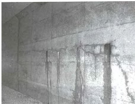
図-10.2.11 凍上によりボックスカルバート側壁に発生したクラック 10)
