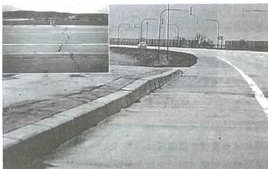
図-10.2.12 凍上によるボックスカルバート上の舗装の押し上げと亀裂 10)
