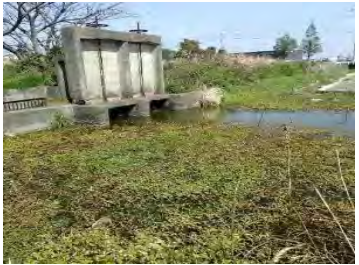
ナガエツルノゲイトウによる 取水の阻害
