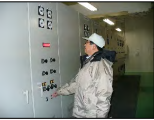
(ポンプの運転)
