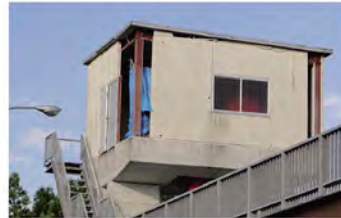
操作室外壁パネルの脱落
