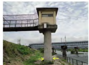
操作室柱基部のひび割れ
