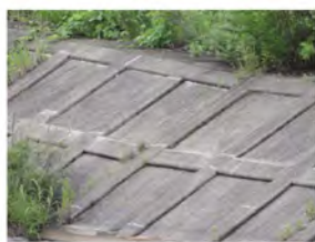
護岸ブロックのひび割れ
