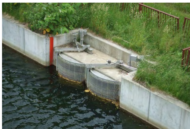
写真-24.4-2 スクリーン＋レーキ型（中里頭首工）
