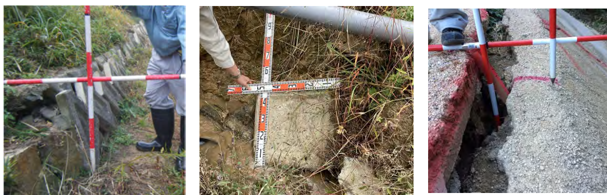
図4-19 被災した構造物の拡大写真の例
