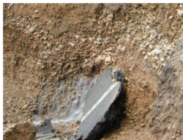
図4-21 崩壊面からの湧水発生状況の例
