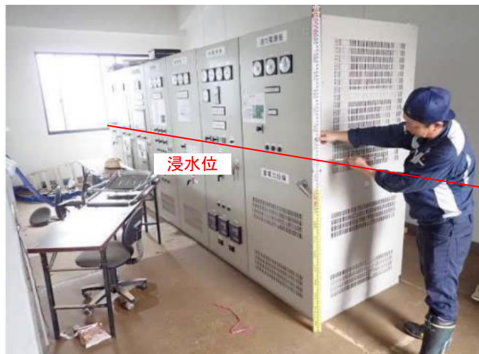
被災した電気設備（操作盤）
