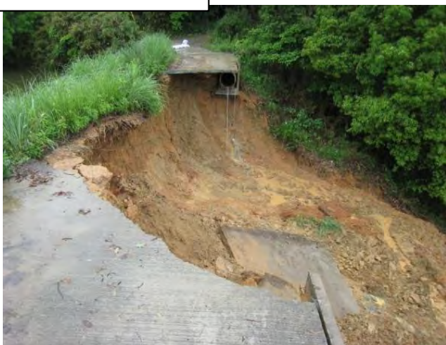
ため池法面崩壊
