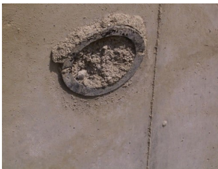
逆締弁手前の固結状況
