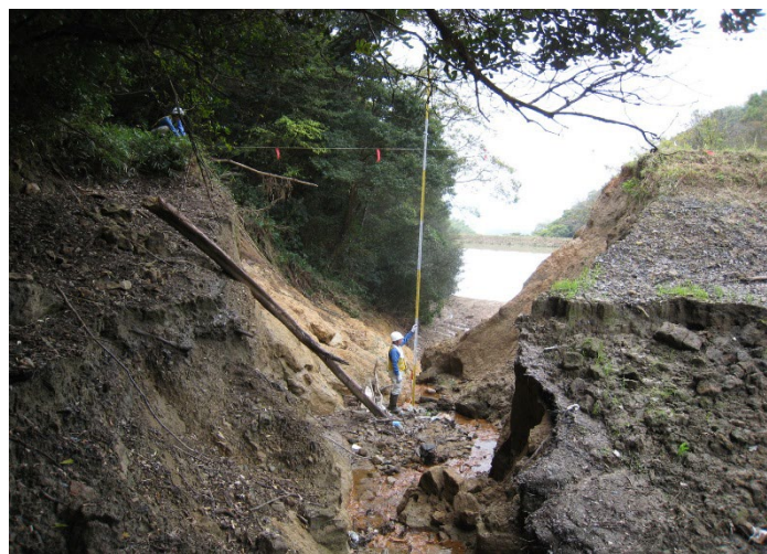
写真 4-2-7 豪雨によるため池余水吐被災事例
