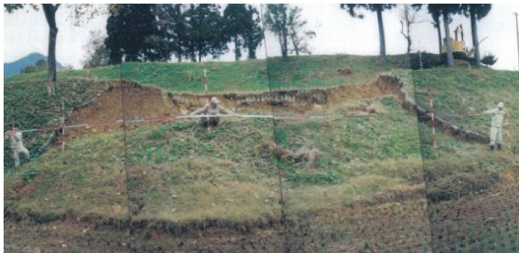
(豪雨により農地畦畔が崩壊)
