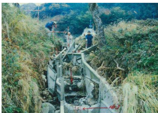
(豪雨により、土砂と同時に水路が流出し崩壊)
