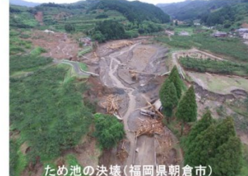
ため池の決壊(福岡県朝倉市)
