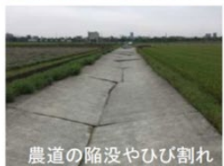
農道の陥没やひび割れ
