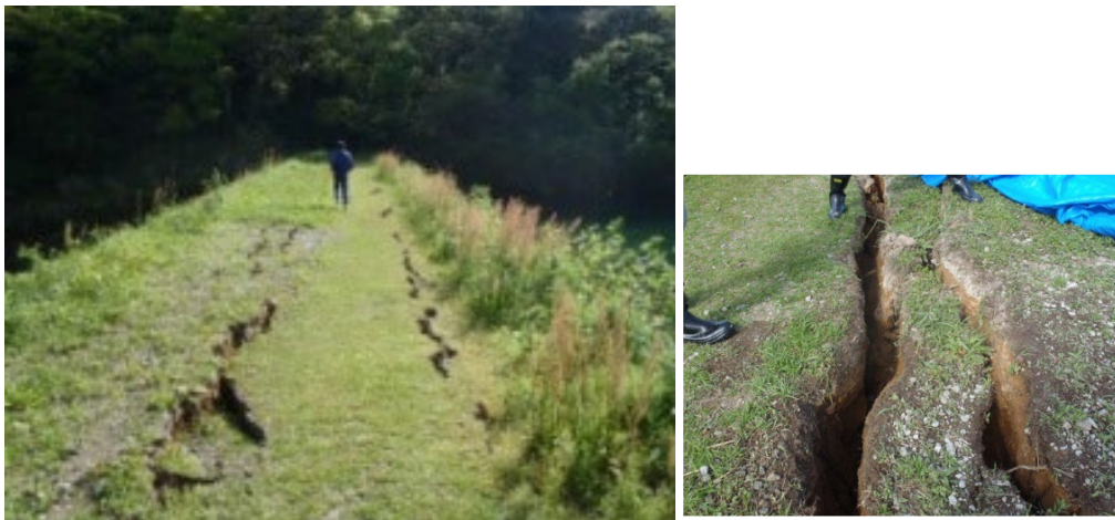
写真 2-8-4 堤体のき裂被害（熊本地震(H28.4)）
