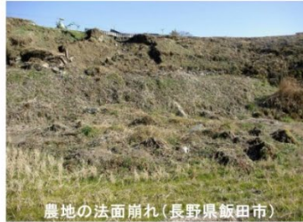
農地の法面崩れ(長野県飯田市)
