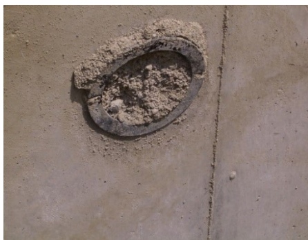
逆締弁手前の固結状況
