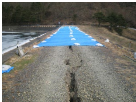
写真 12-2-1 ため池の地震直後の被災写真
