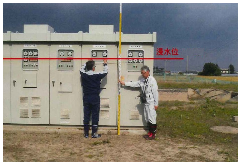
被災した電気設備（操作盤）
