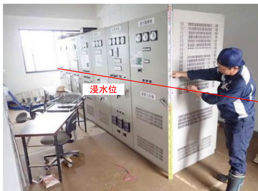
被災した電気設備（操作盤）
