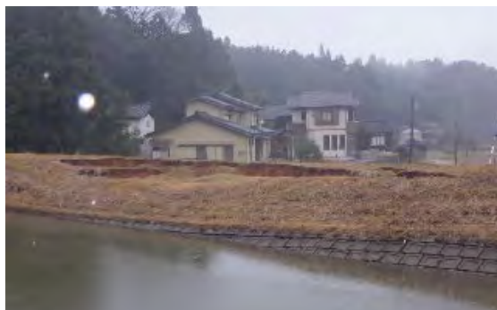
堤体の上流法面が崩落
