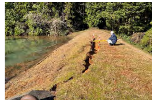
堤体の上流法面が崩落
