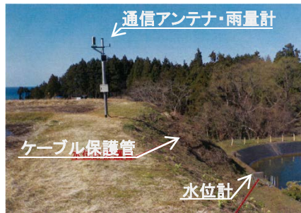
ICT水位計の設置状況
