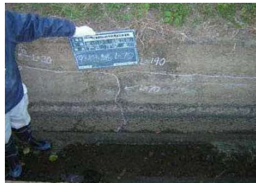
洪水吐構造物のクラック測定
