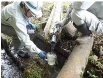
堤体からの漏水量計測
