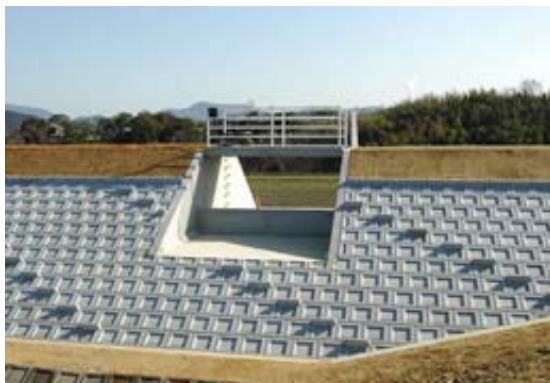
写真1：洪水吐 (香川県HPより)
