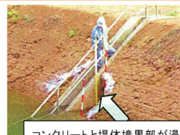
コンクリートと堤体境界部が浸食
