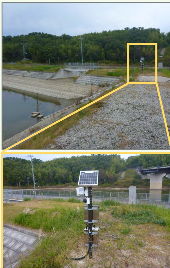
▲ ICT機器（水位計、カメラ）の設置状況
