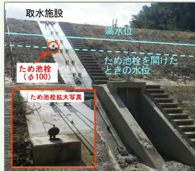
▲ため池栓の整備状況
