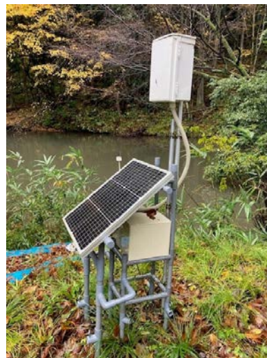
通信装置、電源装置
