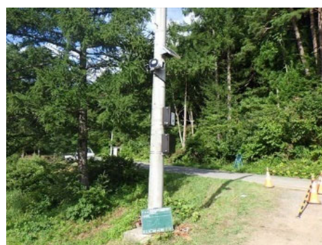
⑤ソーラーパネル、通信機器の電柱添架
