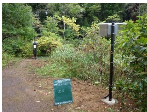
④ソーラーパネルの別立て
