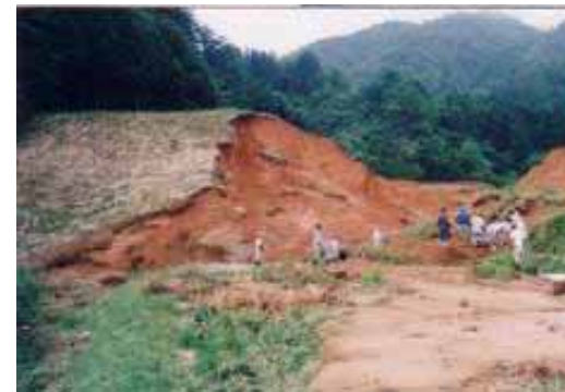
被災したため池
