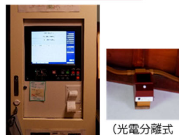
（R型受信機） 高機能な自動火災報知施設を設置し、迅速に初期消火へ
